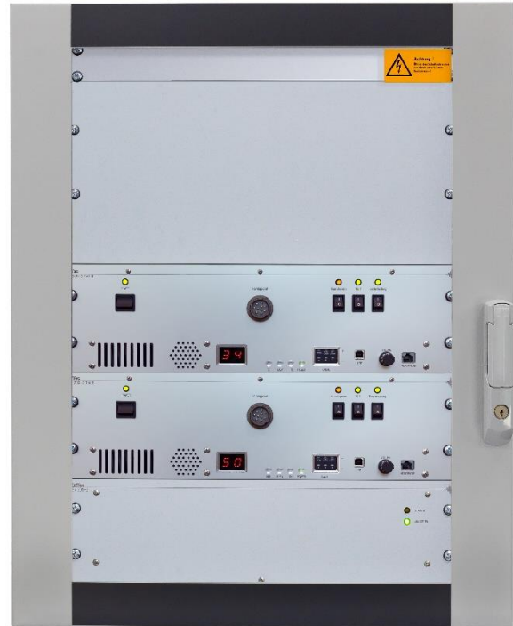
2-Kanal-Anlage im 15 HE-Wandschrank
